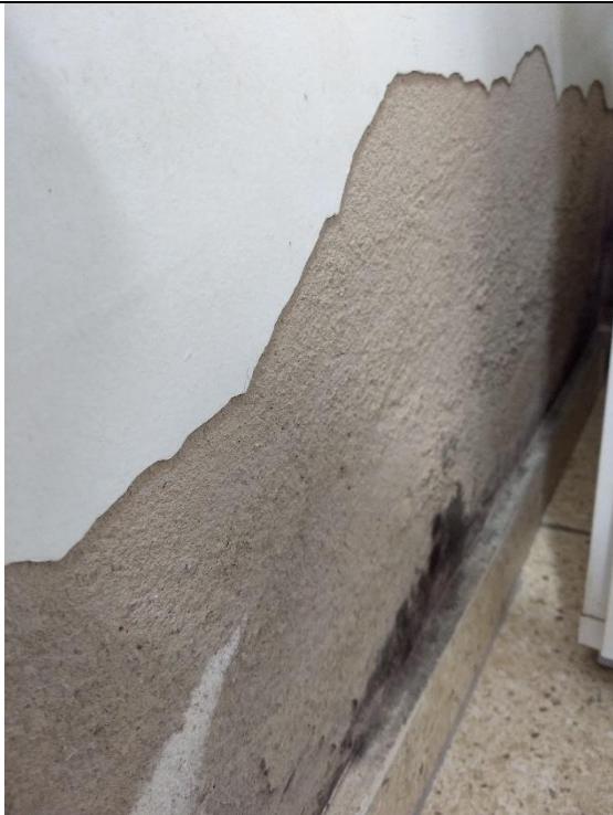
Ascendência de Umidade nas Paredes do consultório geral.
