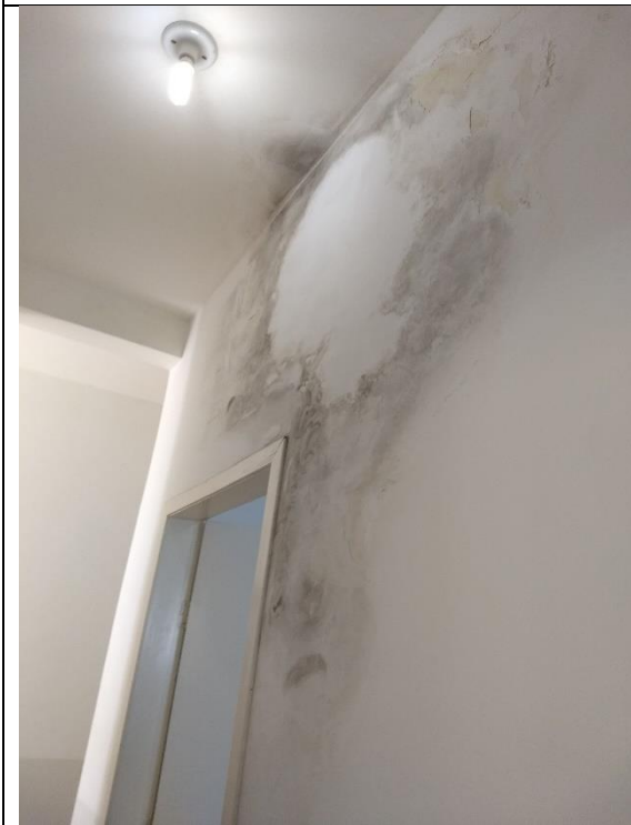
Umidade causada por vazamento do telhado.
