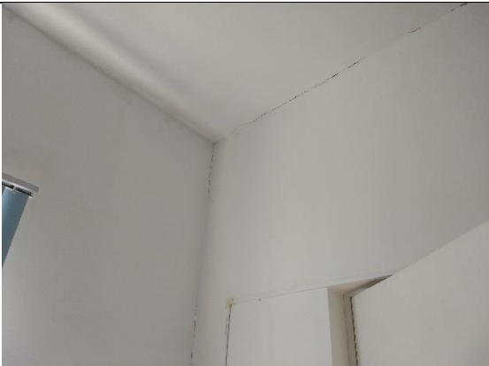
Trinca de junção a ser tratada.
