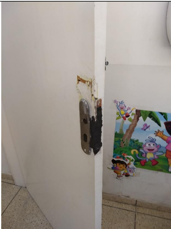
Porta da sala de psicologia que deve ser trocada
