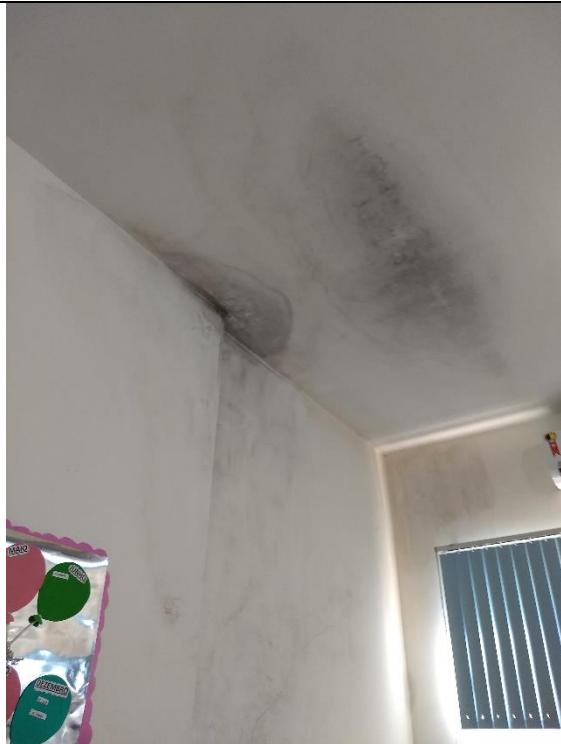
Umidade nas paredes e teto da sala dos agentes
