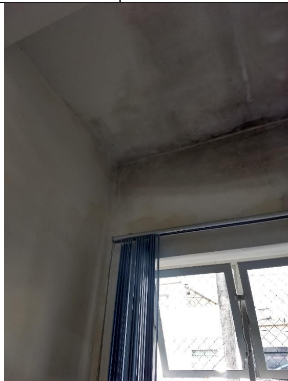
Umidade no teto causada por vazamento do telhado.
