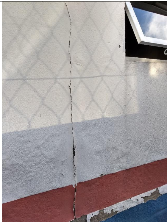
Trinca externa a ser tratada.
